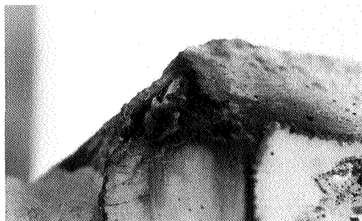
Pop-out en roestuitbloeiing aan de bovenzijde van een wand.
